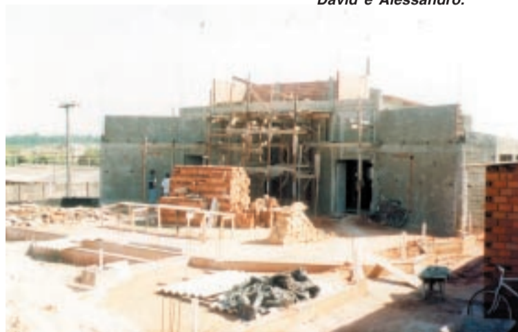
A construção do novo templo em Osvaldo Cruz para a Igreja Batista de Vitória
